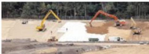
In der alten Aschedeponie bei Wackersdorf sind Arbeiter dabei, den Boden abzudichten. Auf dem insgesamt 70 Hektar großen Areal soll ein Naherholungsgebiet entstehen. Bild: Gerhard Götz
